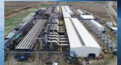
BUHARA Doğal Gaz Kombine Çevrim Santrali 270 MW
