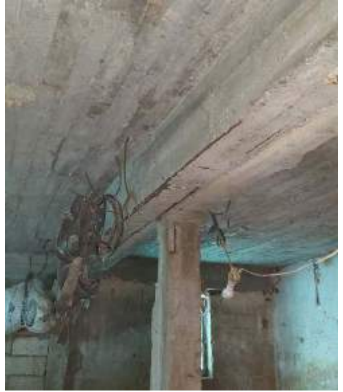
Şekil 11: Korozyon ve nervürsüz donatı
