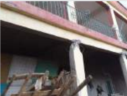
Şekil 9: Enine donatının eksikliğinden kaynaklanan hasarlar
