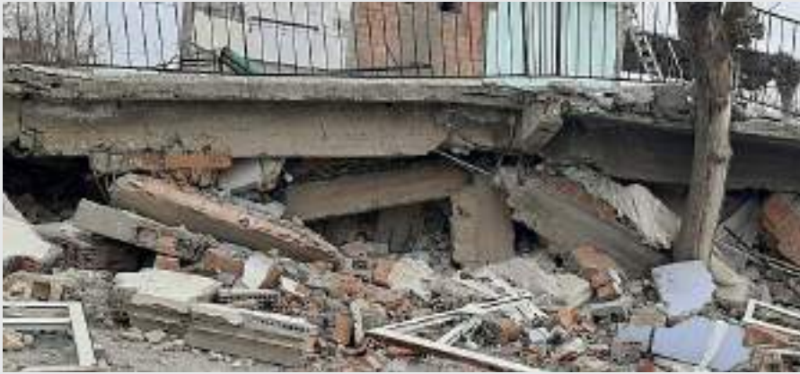
Şekil 6: Kolon Kiriş Birleşim bölgelerinden kaynaklı hatalar
